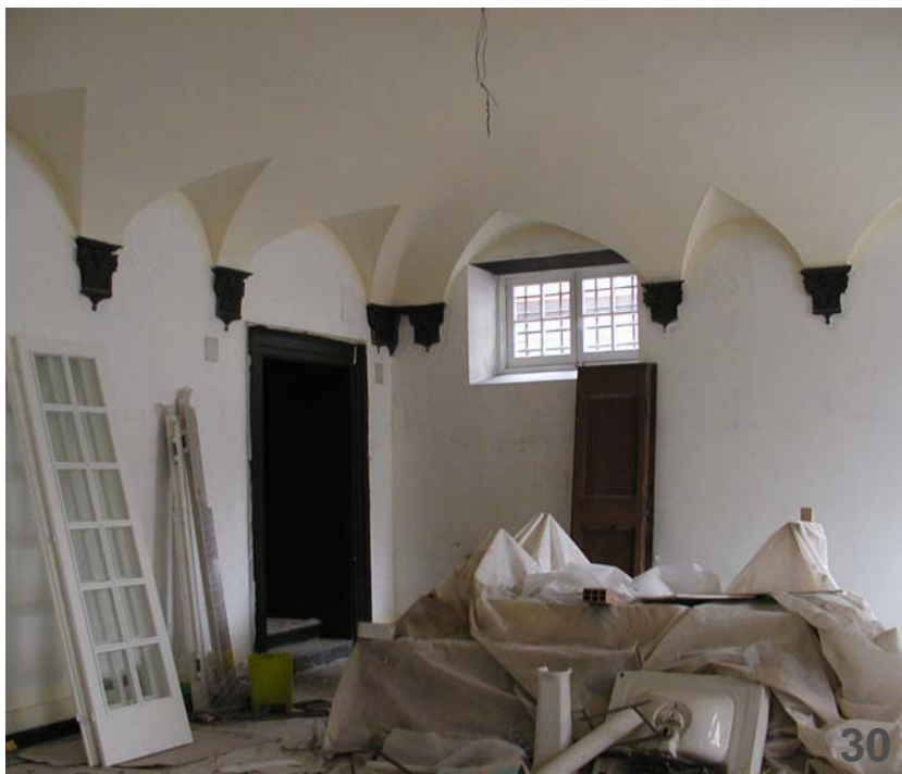
Peducci in ardesia nell'atrio voltato di un palazzo di Via Balbi a Genova
