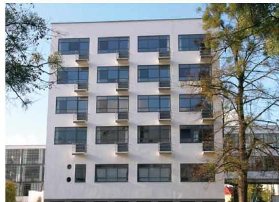
Facciata "Est", "Prellerhaus", intonaco su base di calce aerea, scialbato "a fresco", conservato e restaurato, zoccolo di "Terranova", 2006
